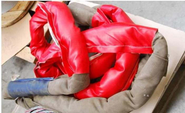
Schutzschlauch in Ordnung
