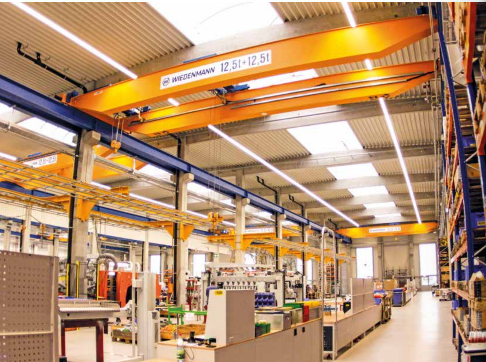
Kranbahnträger (in blau) sowie Krananlagen in einer Endmontagehalle
